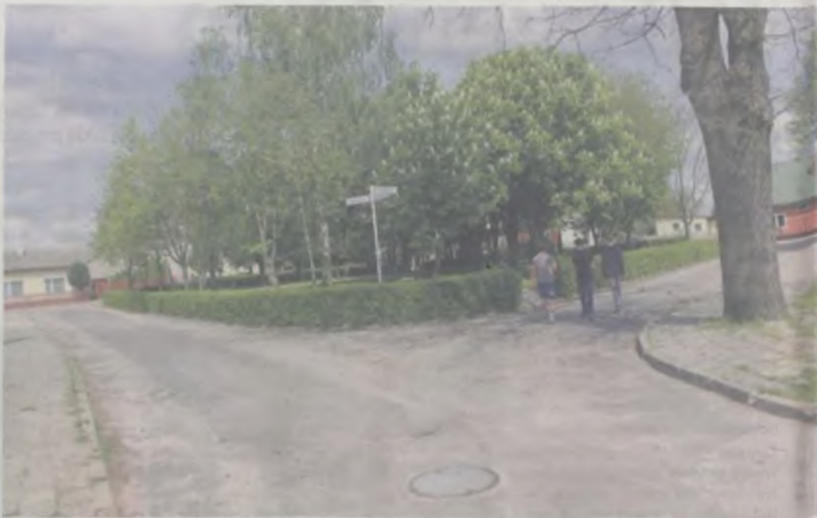
Stan chodników i jezdni na Zamysłowie jest daleki od doskonałości.
