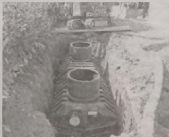
Budowa 129 przydomowych oczyszczalni ścieków w gminie Kawęczyn ma ruszyć w lipcu tego roku.
