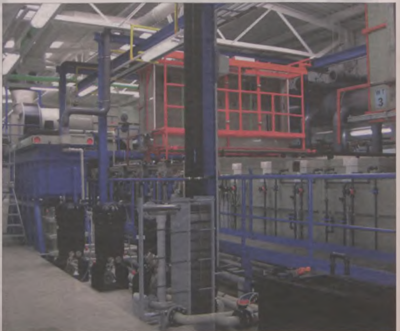
Uruchomiona w 2009 roku galwanizernia zwiększyła ofertę SINTURu. Obiekt powstał przy znaczącym wsparciu środków unijnych.
