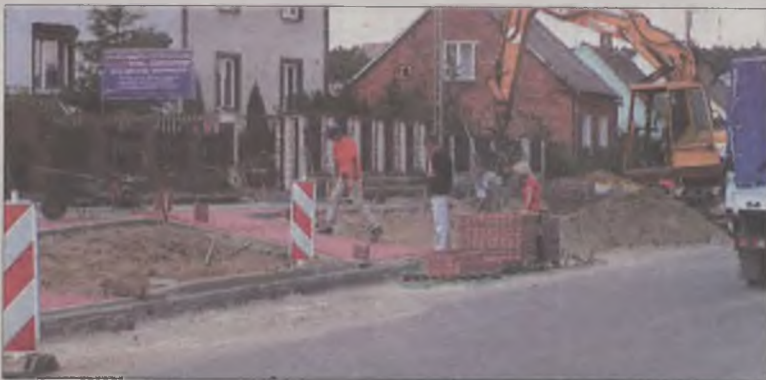
Podjazdy do posesji nie wszystkim mieszkańcom się podobają. W kilku przypadkach nie zgadzają się oni z takim wykonaniem wjazdów na posesję.
