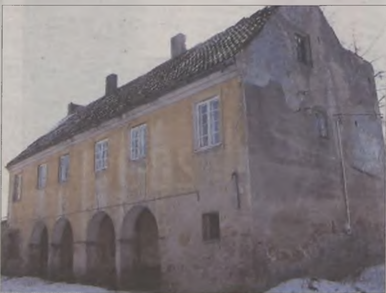
Ruina pałacyku w Kolnicy wreszcie przestanie straszyć.
