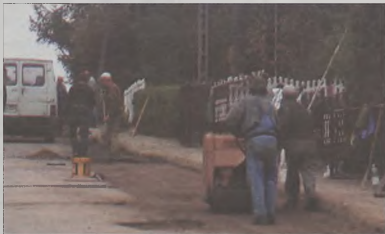
W miejscu, gdzie powstała kanalizacja, nadal trwają prace, za które już zapłacono.
