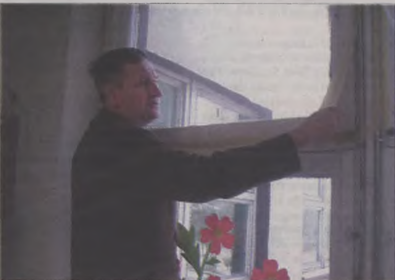
Dzieci w przedszkolu marzną. I nic dziwnego, skoro okna są nieuszczelnione, a role uszczelek spełniają papierowe taśmy biurowe.
