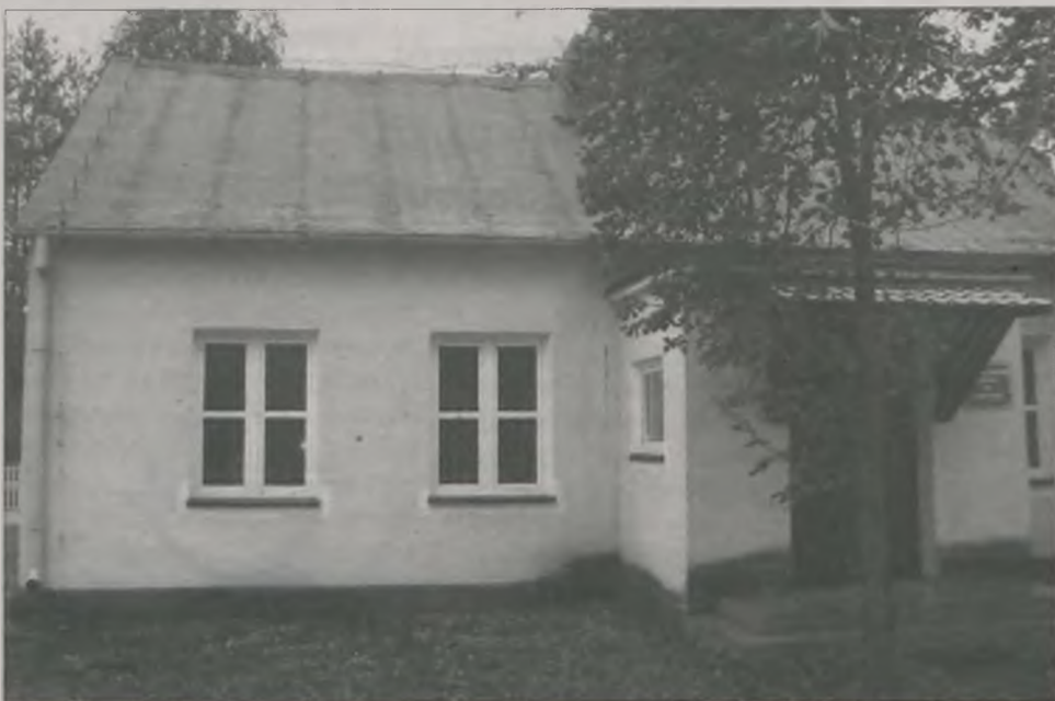
Filia w Radyczynach przed remontem – budynek podmakał na elewacjach widoczne były już spore, zagrzybiałe obszary.
