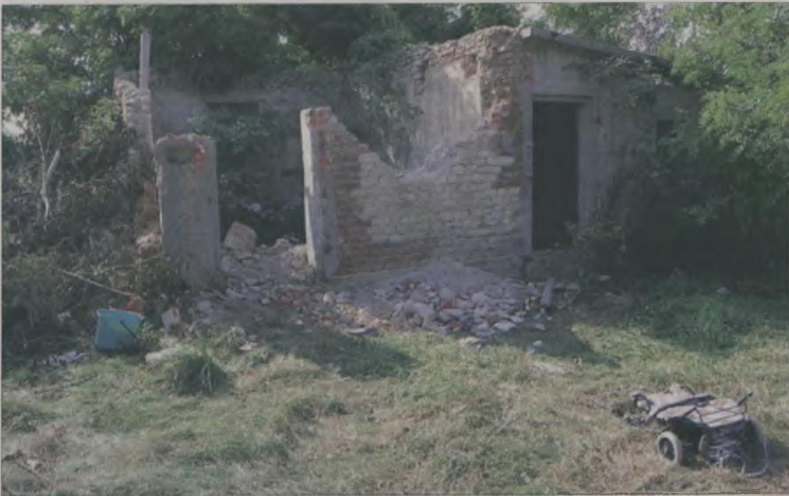
Ruiny pomieszczeń gospodarczych nadają się tylko do rozbiórki.
