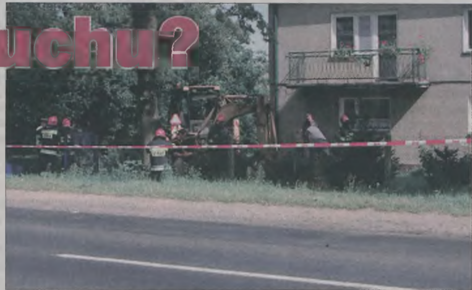
Operator koparki wykonującej roboty ziemne przez nieostrożność, albo brak planów gazowej infrastruktury, uszkodził rurę przyłącza gazu.
