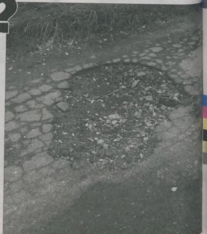
Takie nawet półtorametrowej długości wyrwy w nawierzchni powiatowych dróg, to na terenie gminy Dobra chleb powszedni.
