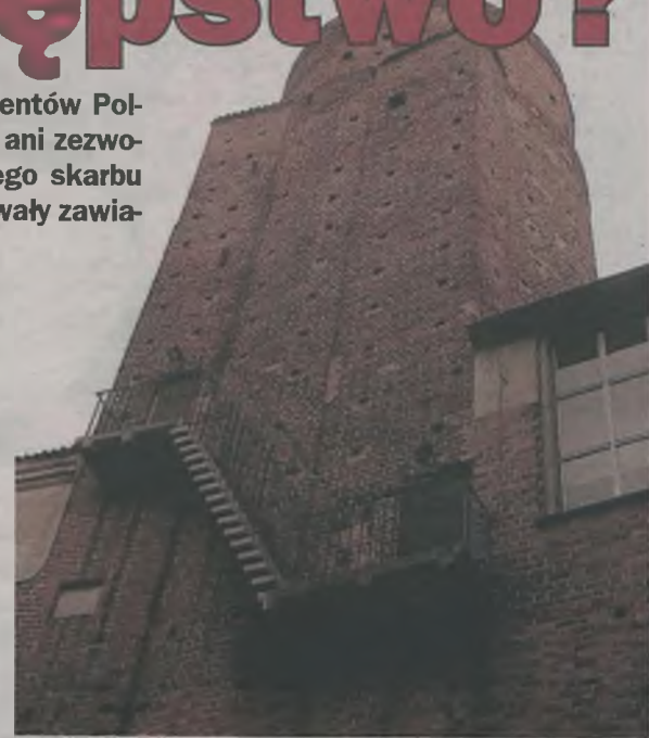
Baszta została w kilku miejscach podziurawiona.
