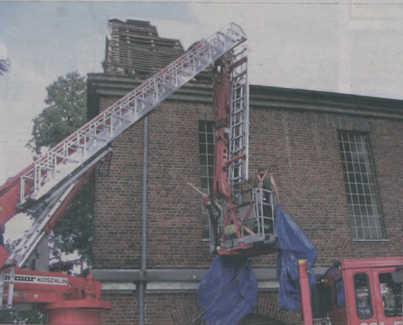
Wiatr zerwał część dachu z janiszewskiego kościoła.
