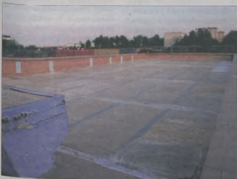
Niepomalowane, zżarte przez rdzę podesty i brak płytek w niecce basenu w Turku. Smutny efekt zaniedbania.
