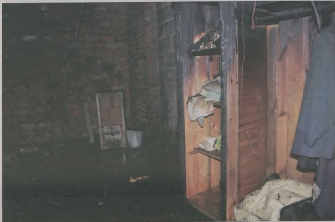
Spaliło się wyposażenie jednego z pomieszczeń.
