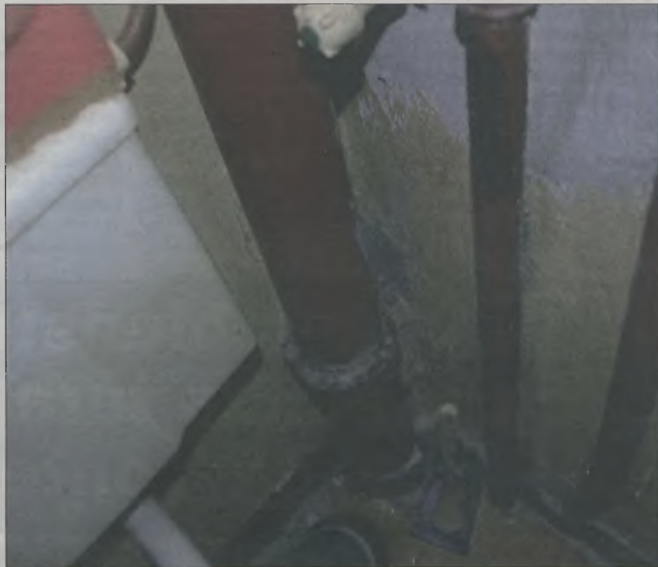
Zwierzę dostało się do mieszkania prawdopodobnie przez wygryzioną w ścianie dziurę.
