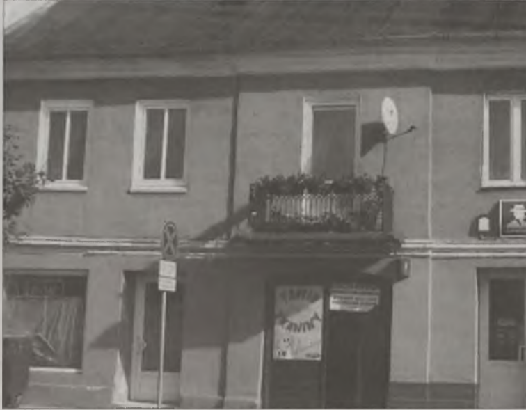
W częstych przypadkach inwestycje w staromiejskie kamienice sprowadzają się do wymiany stolarki okiennej na plastikową.
