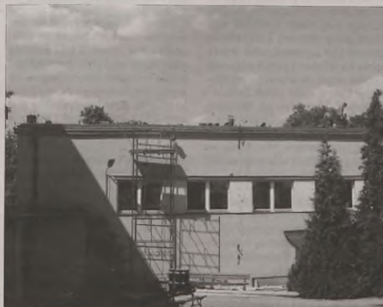
Jak mówi dyrektor Lech Zielony, wymiana pokrycia dachowego na budynku sali gimnastycznej była niezbędna.
