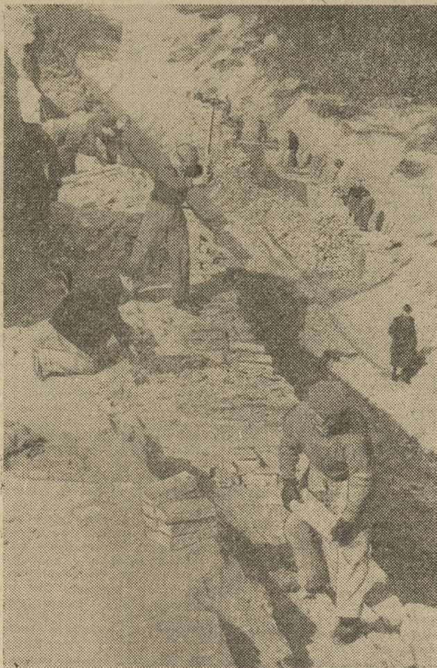
Nie, Ten niezwykły widok przedstawiają od miesiąca stołki poznańskiej Cytadeli. Niby w kamieniolomach uwija się wśród grubych murów kilkudziesięciu ludzi, migają w słońcu kilofy, słychać stuk młotków. To pracownicy Zakładów im. Cegielskiego rozbierają mury zewnętrzne Cytadeli, zdobywając w ten sposób cegły, potrzebne do budowy własnych domków jednorodzinnych. Akcja ta, zorganizowana przez Komitet Budowy Domków Jednorodzinnych przy HCP, przyniesie ogółem około 3 mln. cegieł.
