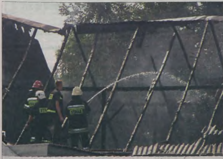
Niemal doszczętnie spaliła się konstrukcja dachu.
