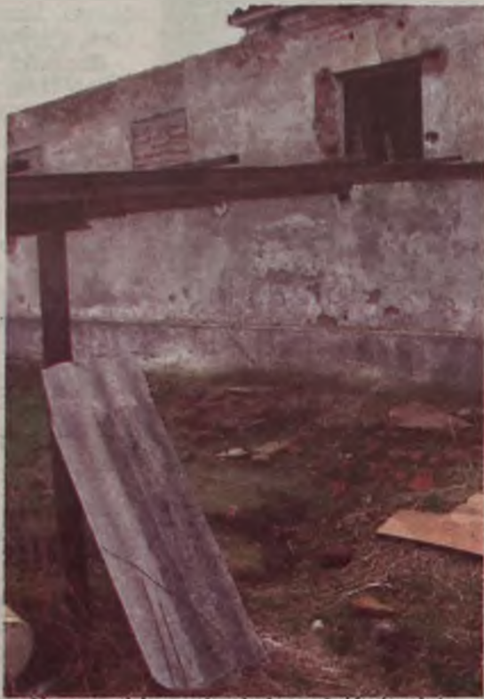
Na wysypisku można było znaleźć również azbestowe elementy eternitowych płyt.
