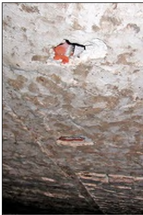
Ślady po kulach w piwnicy – zachowane do dziś.
