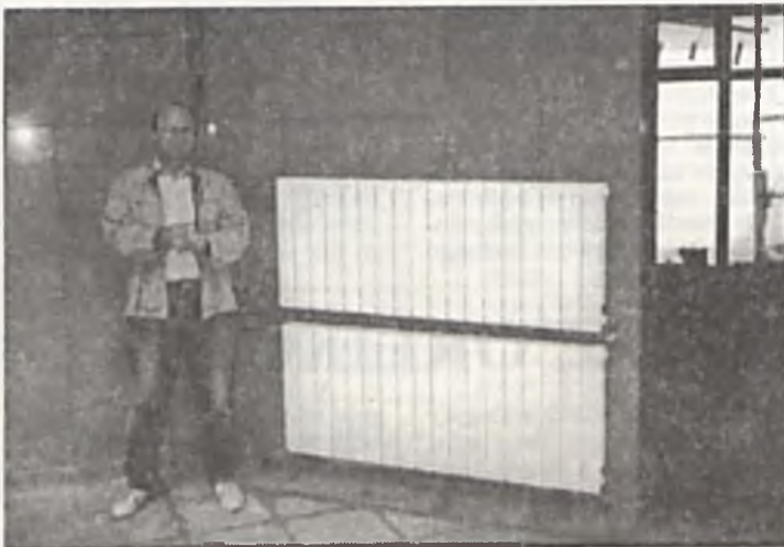
Jan Jaskólski — kierownik budowy obok najnowocześniejszych grzejników włoskich zaistalowanych w Banku PKO BP na poznańskim Piątkowie przez SANBUD.
