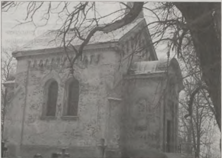
Kaplica cmentarna w Grzymiszewie pochodzi z połowy XIX wieku. Obecny stan obiektu wskazuje na duży stopień dewastacji. Ale i tak jest w lepszym stanie niż pobliski zespół pałacowo-parkowy, też onegdaj należący do rodziny Puławskich.
