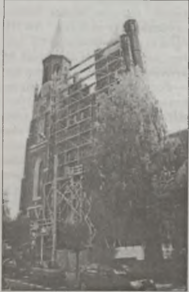
począć prace przy konserwacji kościoła. Cieszyć się tylko można, że skutki dewastacji jego murów były zminima-
