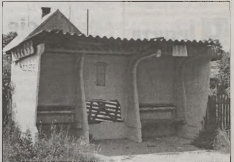
Także przystanek wymaga szybkiej interwencji ekip remontowych
