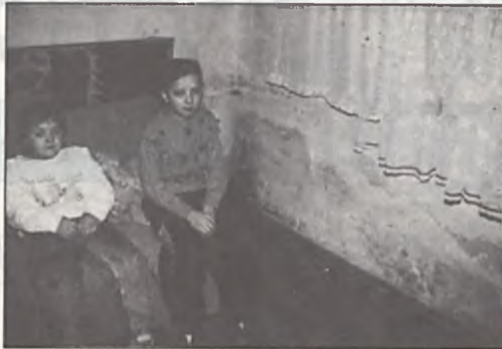
Zawilgocone ściany pogarszają stan zdrowia i tak chorych dzieci.
