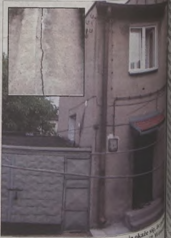
Czy po ewentualnej rozbiórce garażu nie okaże się, że on rolę wspornika dla pękającej klatki schodowej? W tym momencie rozbiórka ta uruchomiłaby swoisty efekt domina.
