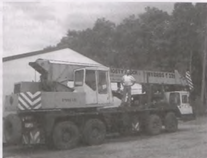
Od 24 lipca rozpoczął się remont wronieckiego mostu. Dzień wcześniej w pobliżu mostu instalował się wykonawca Płockie Przedsiębiorstwo Robót Mostowych we Włocławku. Do zdjęcia pozuje jeden z robotników - Czarek!
