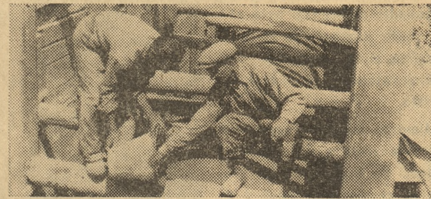
Trójka w składzie: Bolesław Kalwak (na zdjęciu po prawej), Wiktor Porządny i Kazimierz Czyż (po lewej) osiąga najwyższe normy przy pracach związanych z budową głównego kolektora. Sam Kalwak — brygadziści fliskarski wyrabia od szeregu miesięcy ponad 400 proc. normy, zarabując przeciętnie 45 tys. zł miesięcznie
