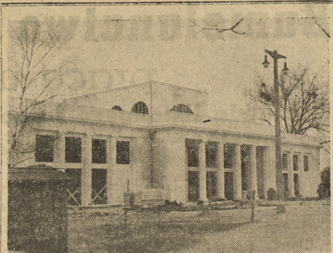
Budowa wspaniałej restauracji P. Z. P. G. w dawnym pawilonie Polonii Zagranicznej w Poznaniu przy ul. Śniadeckich dobiega końca. Odmalowano już zewnętrzne ściany budynku i przebudowano wnętrza. Nowa gospoda obsłuzi w czasie Targów kilkanaście tysięcy gości dziennie. Ponieważ budynek zostanie włączony do terenów targowych — zwiedzający będą mogli spożywać tu doskonale posiłki, nie wychodząc poza obręb M. T. P.
