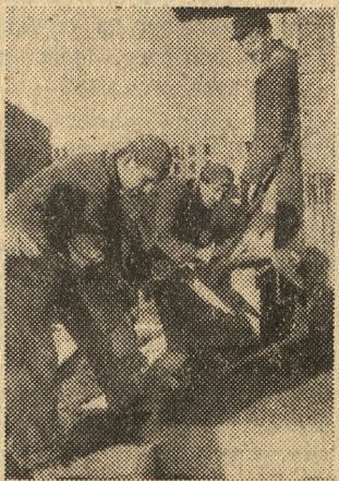
Wyczynowa trójka murarska — Ignacy Zajac, Józef Bajarski i Mieczysław Okupniak, przy pracy w Osiedlu Robotniczym na Dębku
