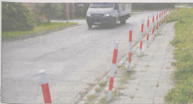
Zniszczone słupki, rozerwane łańcuchy
