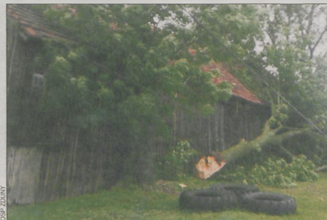
Drzewo przewróciło się na budynek gospodarczy i zerwało linię energetyczną
