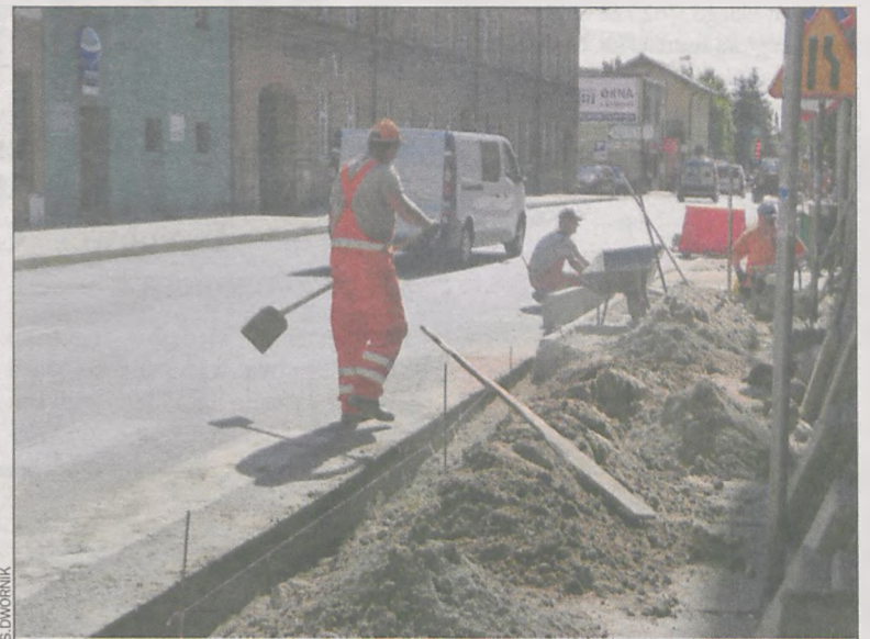
Zniszczone płyty chodnikowe wymienia się na kostkę brukową
