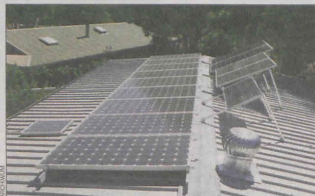
Panele słoneczne to przyszłość
