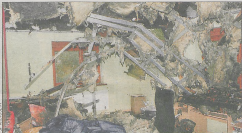
Żywioł poczynił ogromne zniszczenia wewnątrz domu
