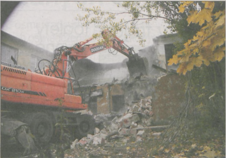
Kilkunastu minut potrzebowało, by prawie połowa budynku przestała istnieć
