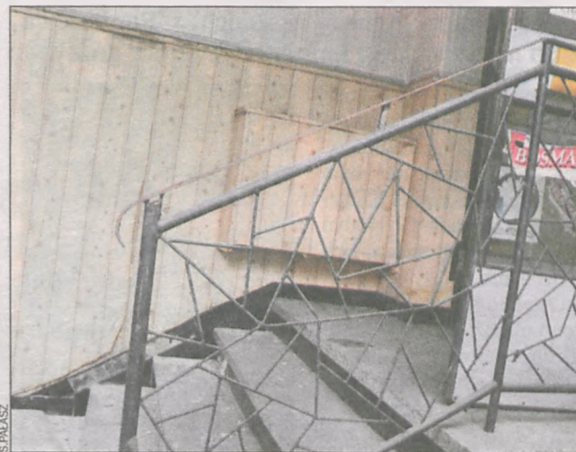
Zrujnowane wejście do Kobylinianki
