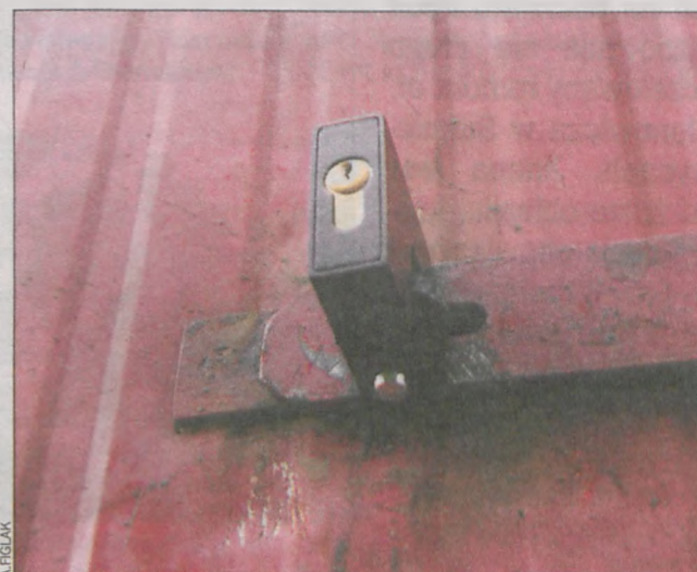
Na drzwiach widać ewidentne ślady próby włamania
