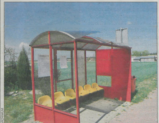
Kosztu naprawy prawdopodobnie pokryje ubezpieczyciel
