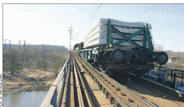
Most kolejowy w Obornikach będzie miał dwa prześła i tory zamiast jednego.
