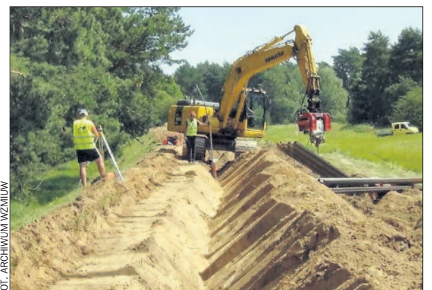
Rzeki i kanały w najbardziej zagrożonych odcinkach są zabezpieczone wałami przeciwpowodziowymi o długości 773 km.
