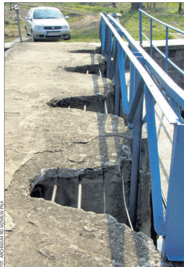
Stan techniczny jazu pozostawiał wiele do życzenia.
