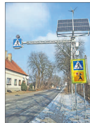
Obok szkoły w Przygodzicach postawiono sygnalizację świetlną zasilaną energią słoneczną.
