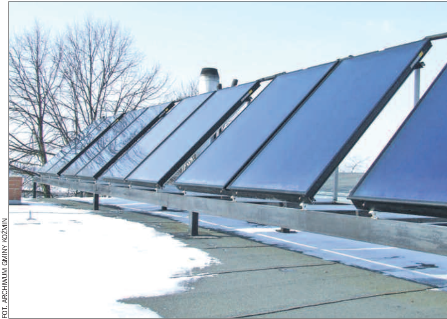
Baterie słoneczne na dachu szkoły w Borzęcicach.
