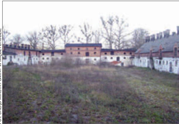
FOT. URZĄD MIASTA I GMINY W MIĘDZYCHODZIE Przed odnową zrealizowaną dzięki unijnej dotacji w Mniszkach straszły rozpadające się budynki dawnej tuczarni.
