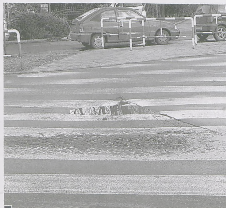
Liście zmieszane z wodą opadową tworzą na przejściu przez ul. Kościuszki niebezpieczną dla przechodniów mazi fot. Hanna Siatka
