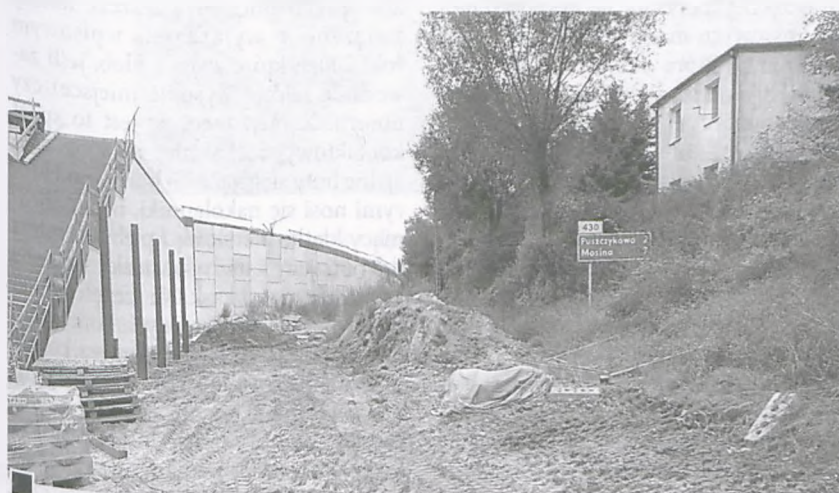
Dom rodziny Mikołajczaków w bliskiej odległości od budowanego wiaduktu nad torami Poznań-Wrocław. Skarpa, na której stoi budynek, w przeszłości podkopana na poczet poszerzenia starej drogi 430, która dziś przebiega pod wiaduktem, zdaniem mieszkańców, dwukrotnie już się obsunęła. Podczas obecnych prac zakopano jej system odwodnienia. W głębi – słup oświetleniowy bez latarni, podobnie jak dom – poza dokumentacją planistyczną fot. Hanna Siatka
