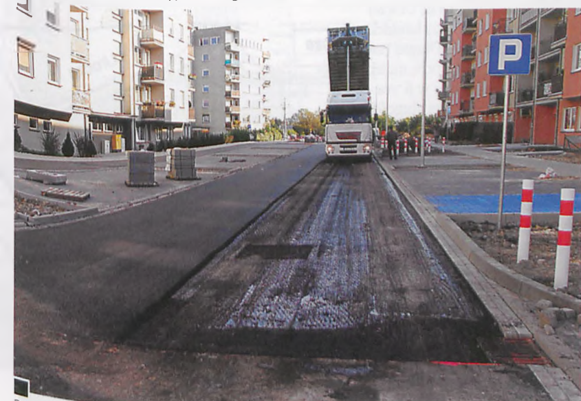
28 września – akcja powtórnego nakładania bitumicznej warstwy ścieralnej w południowej części al. Jana Pawła II, patrząc od ronda na ul. Wschodniej fot. Piotr P. Ruszkowski
