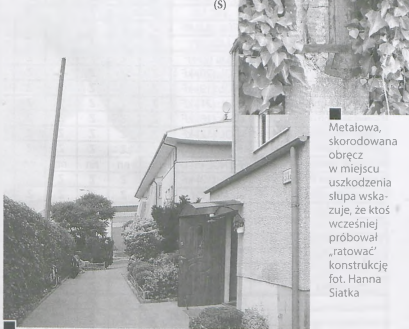
Przechylony w stronę budynków komunalnych przy ul. Niepodległości, uszkodzony, betonowy słup – widok od ul. Przemysłowej fot. Hanna Siatka
