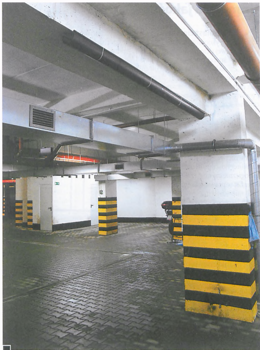
Brak prawidłowo wykonanej izolacji typu ciężkiego skutkuje permanentnym stanem zawilgocenia podstaw obiektu, jak: fundamenty, nasady ścian i posadzki znajdujące się w podziemnej hali garażowej. Niektórzy, w trosce o swoje pojazdy, w najniższych miejscach stropu, tam gdzie zbiera się woda i grawitacyjnie opada, montują specjalną rynnę na szerokość samochodu. fot. Piotr P. Ruskowski
