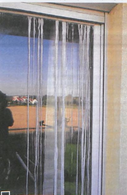
Zacieki agresywnych środków chemicznych na szybach i stolارce okiennej fot. „Opinia techniczna”
