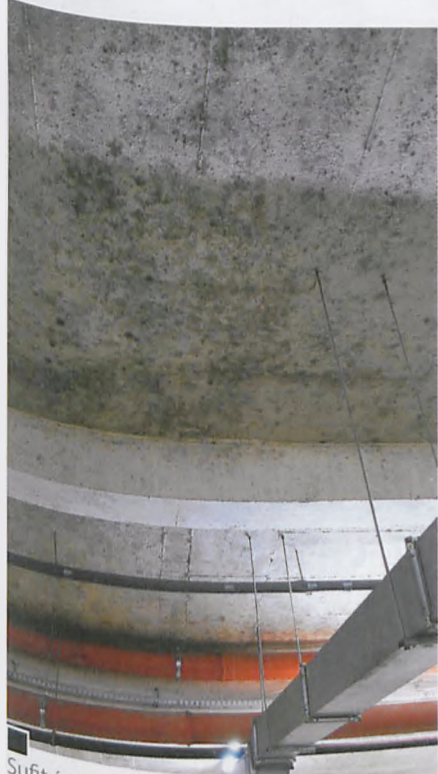
Sufit ścian garażowej „usłany” wykwitami jasnej pleśni i czarnych ognisk grzybiczych fot. Piotr P. Ruskowski
