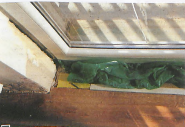
Zacieki murów i tynków wewnątrz jednego z mieszkań o złej izolacji płyty balkonowej fot. „Opinia techniczna”
