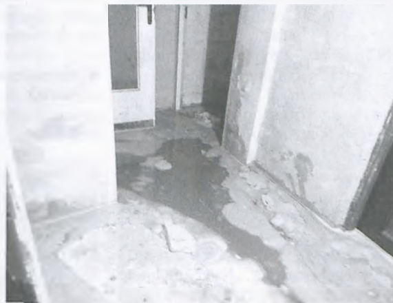
Piwnica domu państwa Lisieckich całkowicie zalana przez deszczówkę, która powoduje zawilgocenie ścian i stolarki drzwiowej
