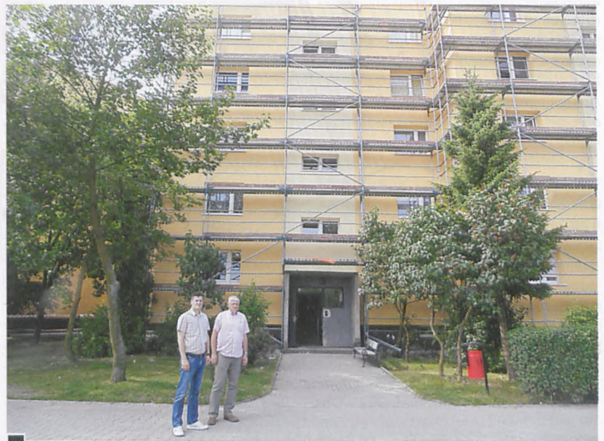
Prezes Piotr Konik i kierownik Działu Eksploatacji – Mikołaj Kujawiński – przed docieplanym budynkiem przy ul. Sikorskiego 41 fot. Jan Błaszczak
