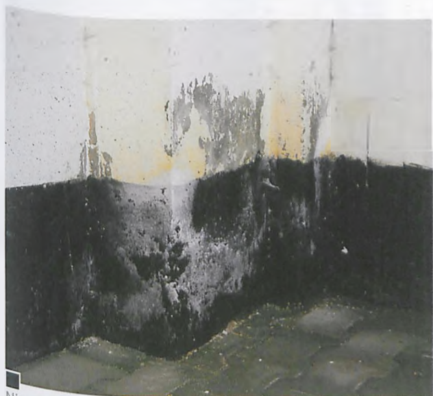
Niewiele daje zabezpieczenie od dołu żelbetonowych ścian zewnętrznych hali garażowej czarną masą bitumiczną. Łatwo zauważyć wykwit solne oraz jasną pleśń, która w kontraście jest jeszcze bardziej widoczna. Po ulewnych deszczach można też zaobserwować przecieki ścian zewnętrznych fot. Piotr P. Ruskowski
