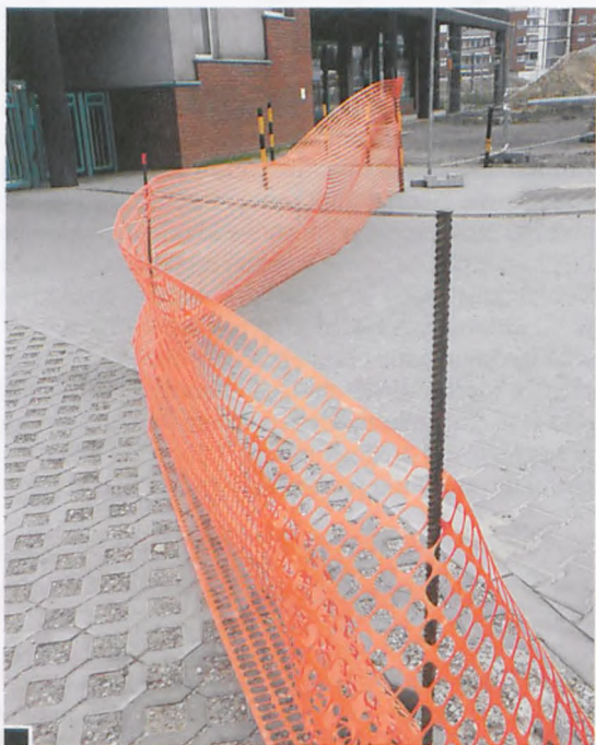
Niedbale zabezpieczone przejście przy rondzie budowanym w NCL, od strony ul. Pułaskiego. Aż strach pomyśleć, co się stanie, kiedy będzie tędy przechodzić grupa rozbawionych dzieci czy młodzieży, popychając się wzajemnie fot. Hanna Siatka
