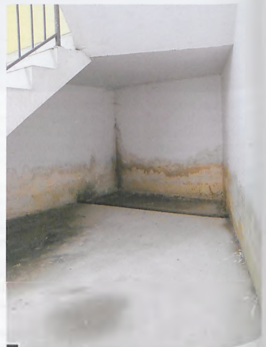
Stopień permanentnego zawilgocenia ścian piwnicy na klatce schodowej fot. Piotr P. Ruszkowski
