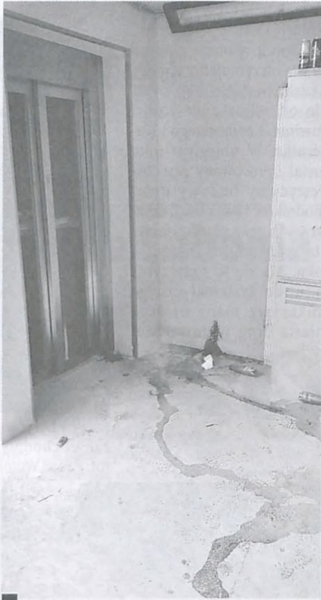
Zanieczyszczone fekaliami okolice windy w nowym przejściu podziemnym przy ul. Fabrycznej (2 kwietnia)
