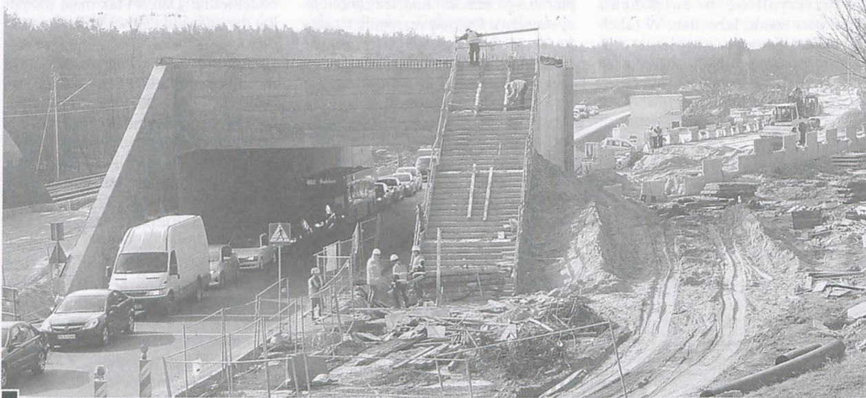
Wiadukt nad przedłużeniem ul. Krętej w kierunku Łęczycy, na który prowadzi prawie 50 stromych stopni z podestami przyzankowymi co 12 stopni (wysokość ok. dwóch pięter). Nie przewidziano nawet windy. Wózki, niepełnosprawni, rowerzyści będą skazani na przebycie dodatkowych 1000 m (do ronda w Łęczycy i z powrotem – drogą 430 biegnącą górą). W tunelu wiaduktu sznur samochodów stoi na przedłużeniu ul. Krętej (z chodnikiem) w kierunku Łęczycy fot. Piotr P. Ruszkowski
