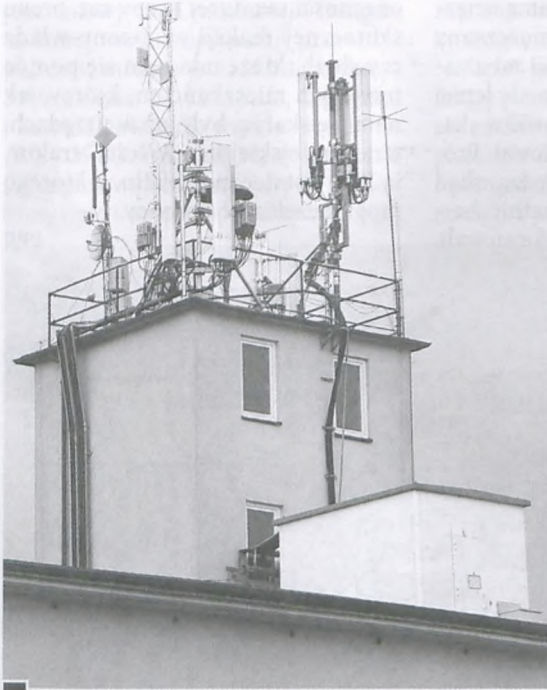
Wieża OSP, na której zainstalowano system różnych anten. Do ich zasilania i przetwarzania sygnałów, na dachu poniżej zamontowano specjalny kontener połączony z antenami siecią grubych kabli. Instalując wszystkie te urządzenia, przy okazji zaburzono ład architektoniczny tej dominanty obiektu OSP fot. Piotr P. Ruszkowski
