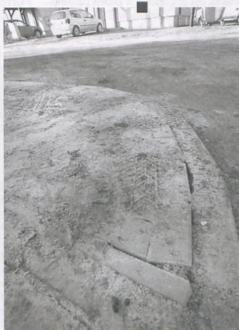
■ W nowym chodniku na ul. Jesiennej pozostawiono niedoróbki polegające na nierównym ułożeniu kostki i szparach na niektórych połączeniach. Zamaskowano je zasypując piachem fot. Hanna Siatka
