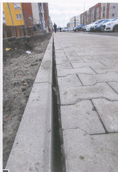
Powiększająca się po zimie szczelina pomiędzy krawężnikiem i kostką brukową-chodnika na oddanej przed kilkoma miesiącami inwestycji na ul. Wschodniej fot. Piotr P. Ruszkowski
