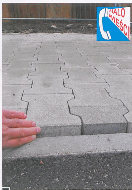
Kostka chodnikowa miejscami wystaje ponad krawężnik połączenia ze ścieżką rowerową na wysokość dwóch palców. – Nie mniej rzecz ogólnie biorąc, iść się po tej drodze dało... (ostatecznie może?) ... Przyjdzie walec i wyró... fot. Piotr P. Ruszkowski
