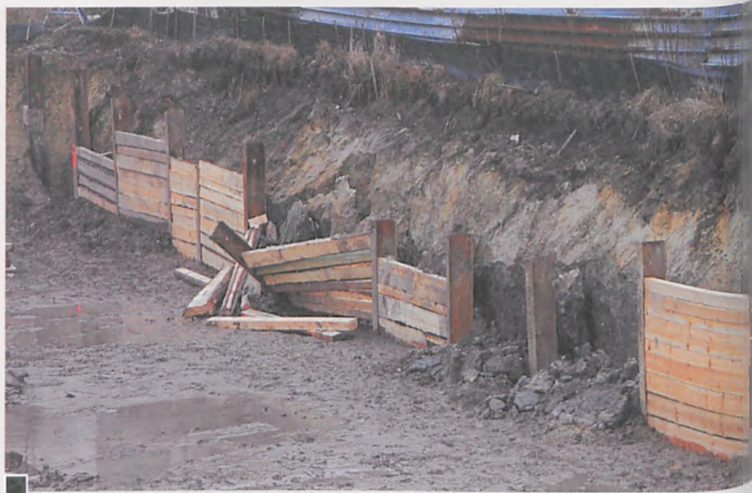
Drewniana ścianka opinkowa w wykopie przy ul. Wschodniej 19 przewróciła się w grząskim, gliniastym podłożu pod wpływem osunięcia się gruntu przyległego do ogrodzenia i drogi wewnątrzsiedlowej fot. Piotr P. Ruszkowski
