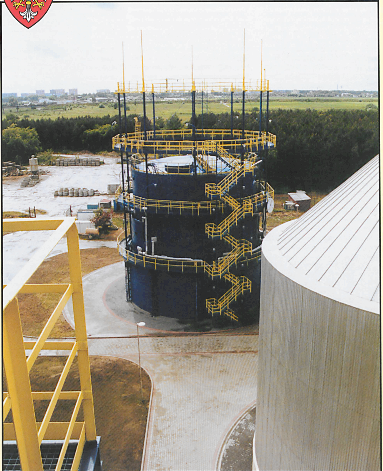
KOZIEGŁOWY – CENTRALNA OCZYSZCZALNIA ŚCIEKÓW
