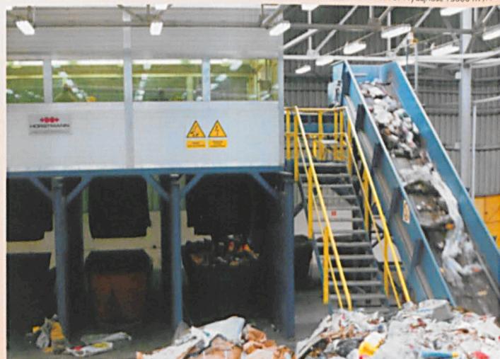
Wołomin - Linia sortownicza odpadów komunalnych suchych. MZO Wołomin 1998. Wydajność 15000 m 3 /rok.
